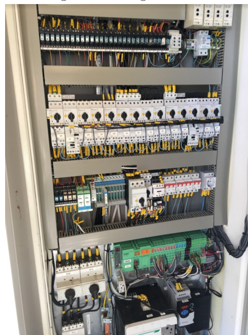
Figur 11: Kontrollpanel inuti kontrollhuset.
