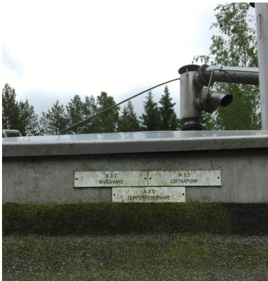
Figur 6: Nivågivare, luftare och temperaturgivare.
