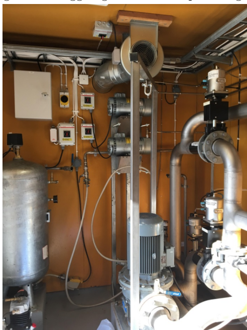
Figur 10: Ledningar inuti kontrollhuset.
